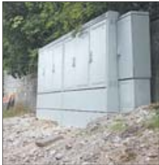
Alles bereit: Die Technik für DSL-Anschlüsse steht schon an der Bürgermeister-Rasch-Straße. Krings
